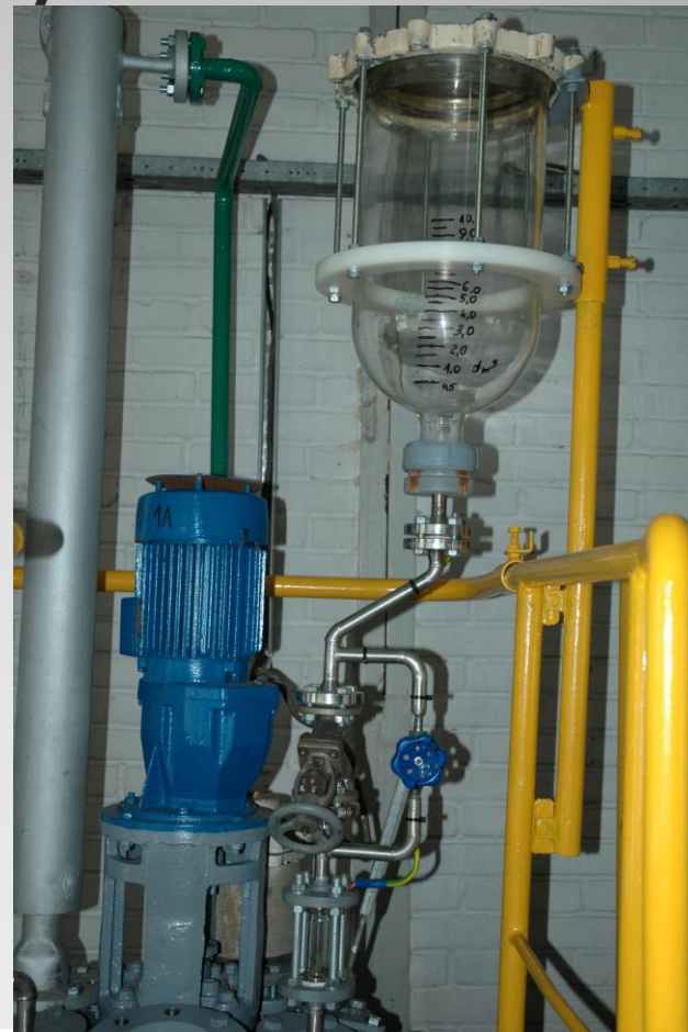
Węzeł dozujący instalacji wyposażonej w reaktor emaliowany V-200 litrów
